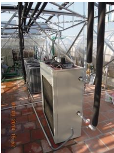
Hệ thống cung cấp nước nóng sử dụng bơm nhiệt kết hợp với bộ thu năng lượng mặt trời công suất 30m 3
